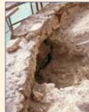
Struttura muraria: stato di degrado
